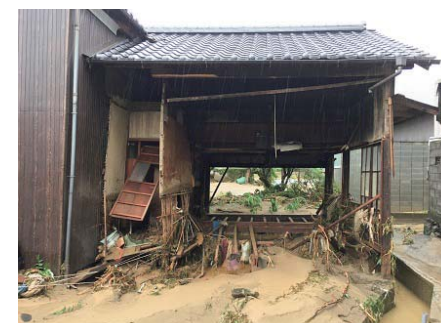
写真6 柱の梁も折れている
