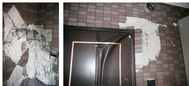
写真2 2005年福岡県西方沖地震のときのマンションの被害
