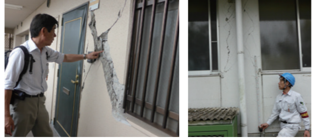
熊本地震で被災したマンションのクラックを調べる古賀先生。「被災した建物を診断する際、『どう壊れたか』より『どう直そうか』という目で見ています」
