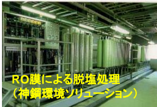
電気透析膜による脱塩処理 (クボタ)
