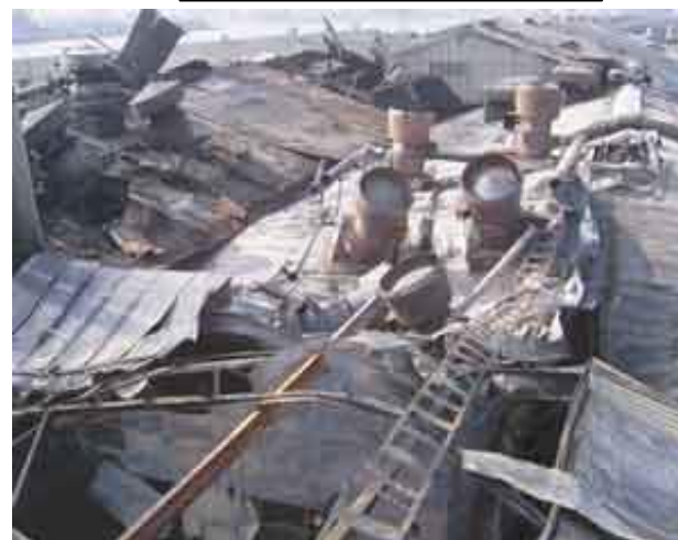
工場の被災状況
